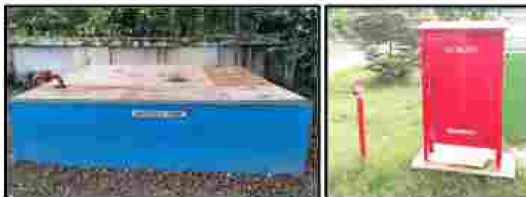
Gambar 2.16 Hydrant dan tandon air suplai PMK
